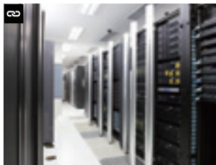
水枝数据中心
