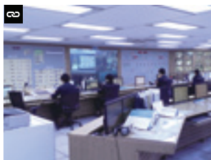
都塔综合监控室
